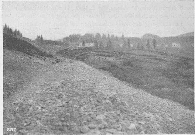
Abb. 30. Bodenaufpressung seitlich des Bahndammes im Sumpf des Doubstales bei l'Abergement.
