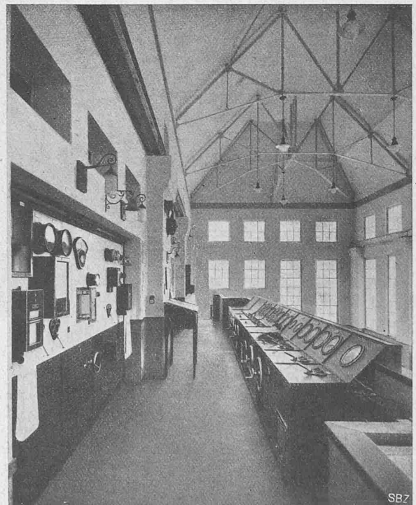
Abb. 35. Blick auf Schalttafel und Schaltpult.
