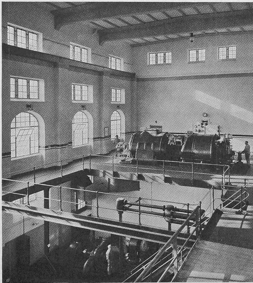
Abb. 40. Innenansicht des Dampfturbinenraumes im I. Ausbau.
