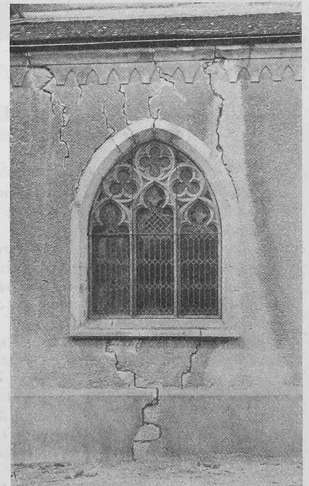
Abb. 19. Südl. Kapellenfenster mit Rissen.
