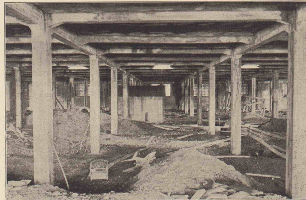
13. Fabrikanlage der Herren Schöeller, Chessex & Cie, Schaffhausen. Blick in das innere des Kellergeschosses
