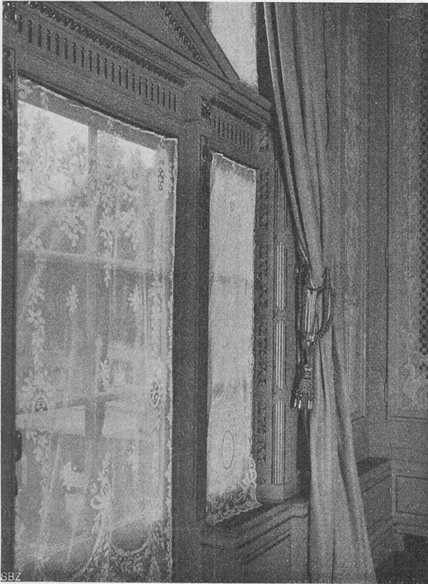
Abb. 32. Fensterheizung im Burgerratssaal des Berner Kasino.
