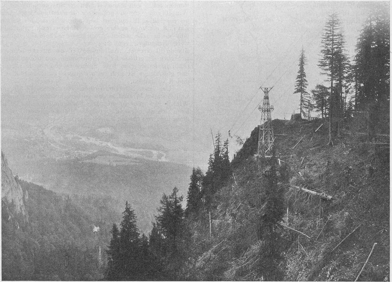
Abb. 7. Blick von Km. 13 nach Station III (in der Ferne Busteni). — Maximale Seilspannung von 650 m.
