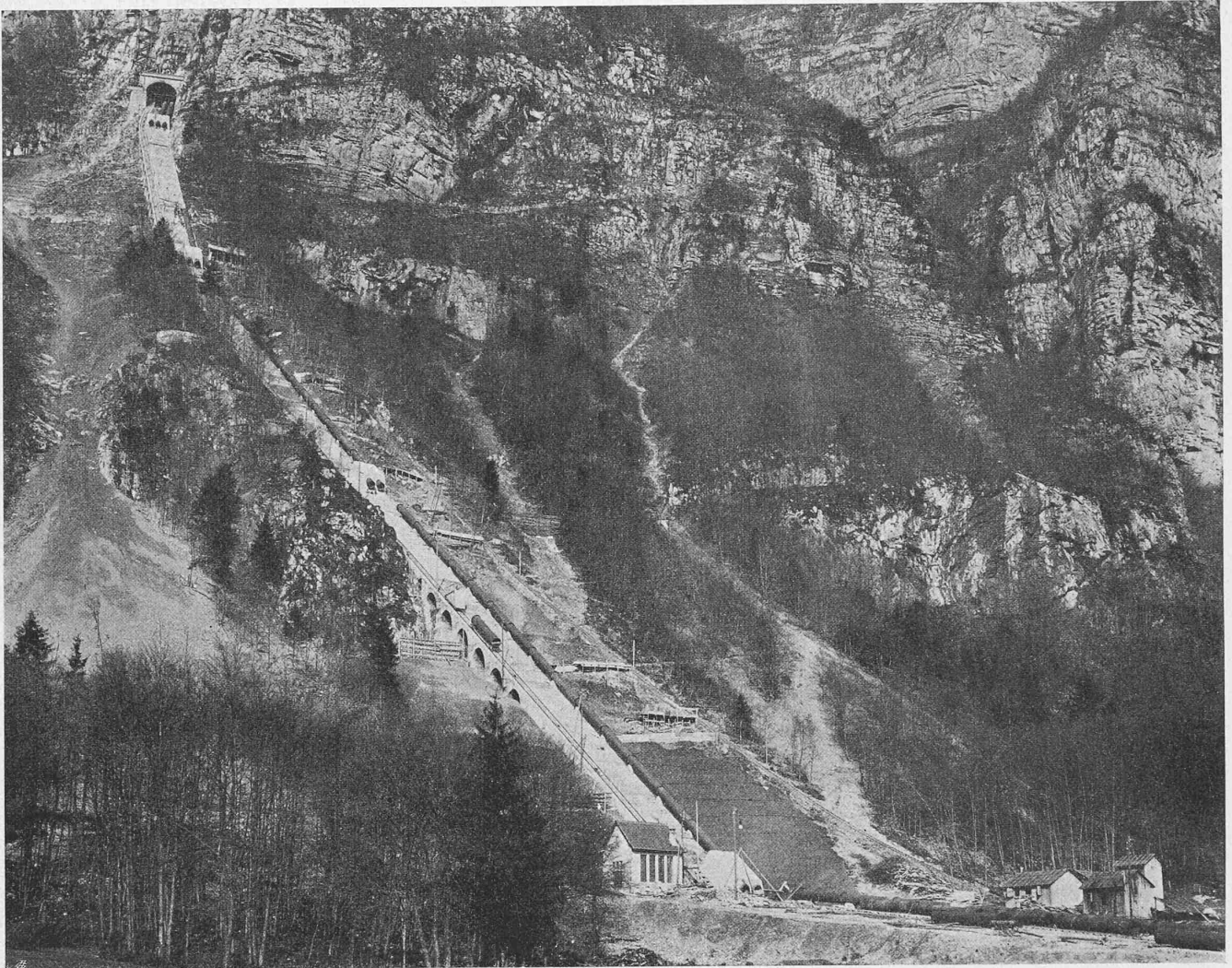
Abb. 70. Blick auf die Steilpartie der Druckleitung mit beiden Seilbahnen, während der Rohrmontage (1. Mai 1908).
