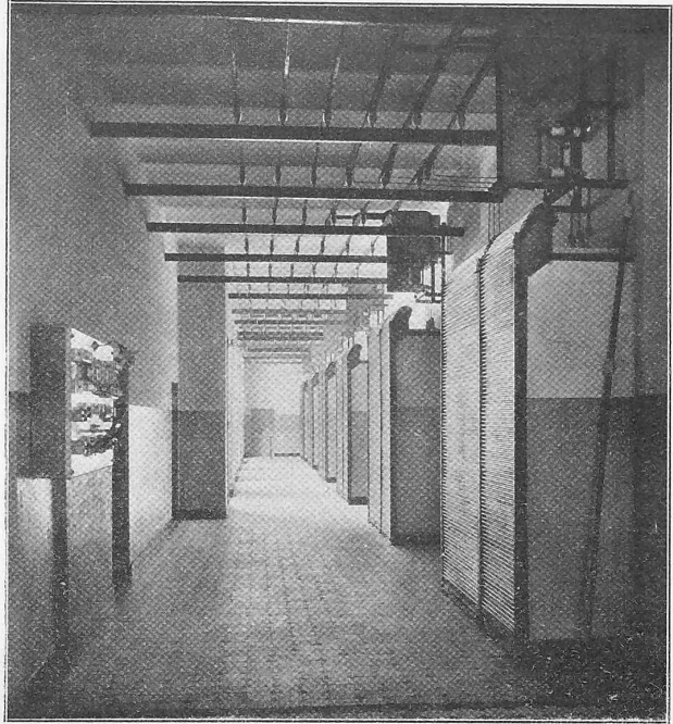
Abb. 42. Apparatenraum und Hochspannungs-Sammelschienen.
