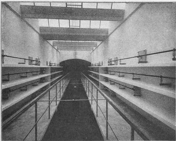
Abb. 50. Leitungen von 7000 Volt in der Galerie im Mittelbau.
