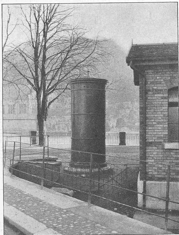
Fig. 14. Transformatorstation für unterirdische Primär- und Sekundärleitung.
