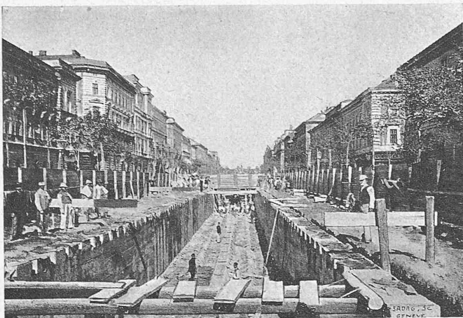
Fig. 2. Baustelle in der Andrassystrasse zwischen der Eötvösgasse und Csengerygasse nach Beendigung der Seitenmauern und der Sohle.
