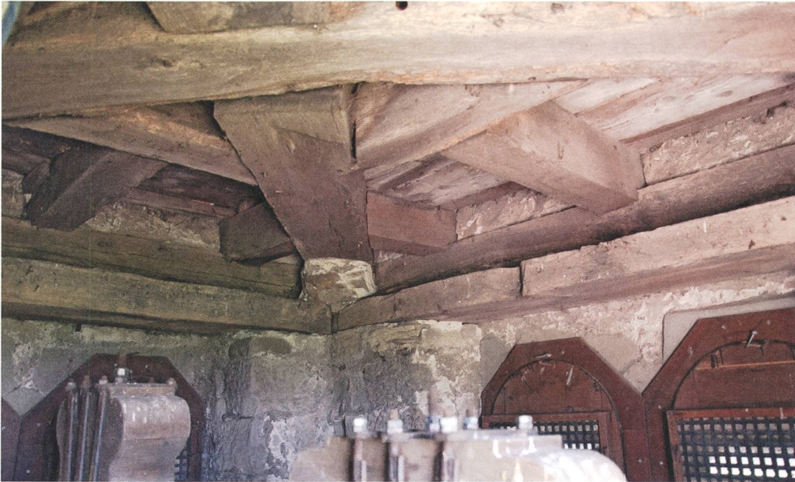
Abb. 49: Im Glockengeschoss des Turms von 1702 tragen die kräftigen Eichenstürze auf den Kalkbruchsteinecken das Eichengebälk des Spitzhelms.
