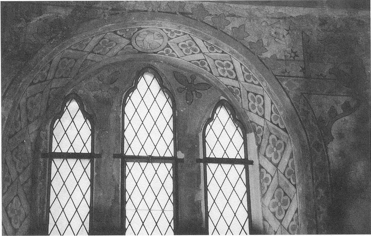
Abb. 4 (oben): Stein am Rhein, ehemalige Klosterkirche St. Georgen, Nordkapelle, Ostwand: Detail der Fensterornamentik. (Aufnahme: Heike Schweizer 1992)
