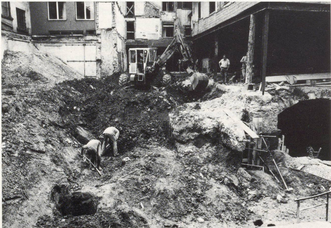
Abb. 3 Im Wettlauf mit der Baggerschaufel werden im hausnahen Bereich Gerbergruben freigelegt und dokumentiert.
