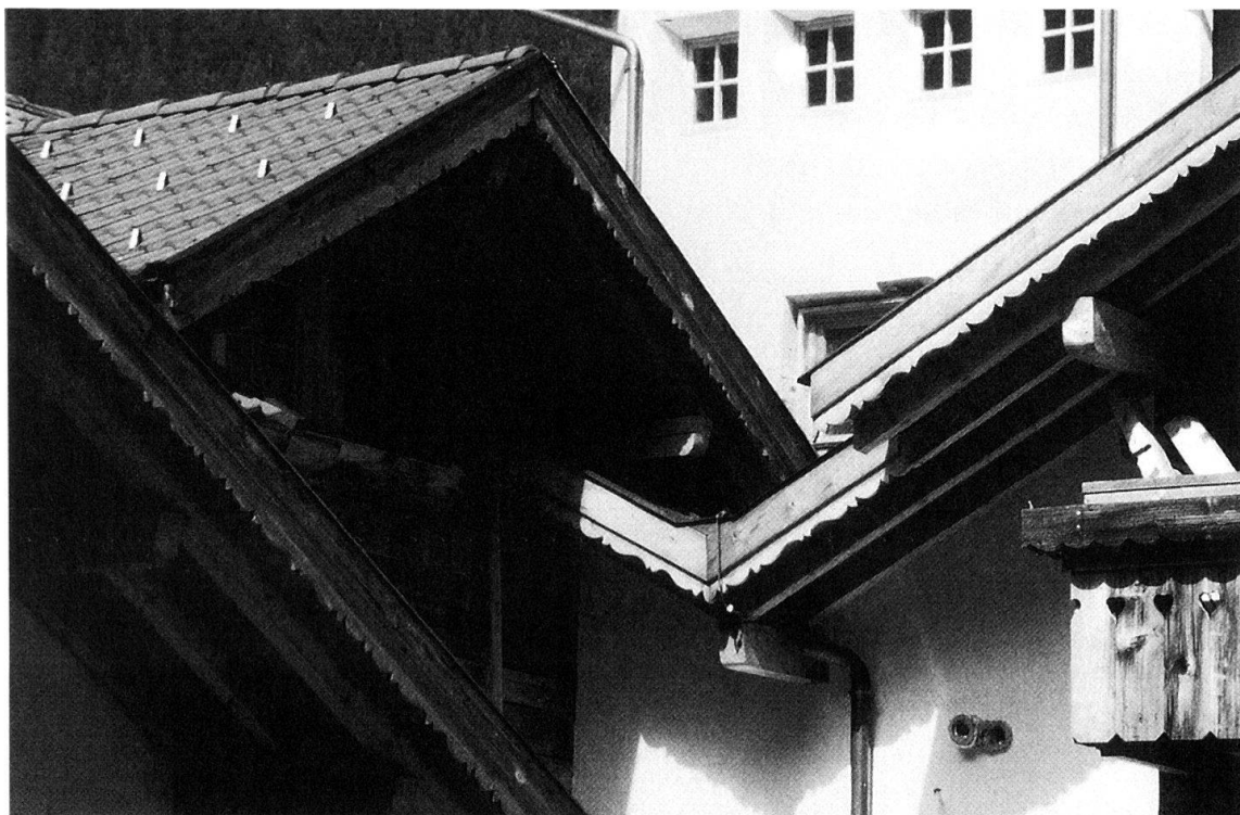
Abb. 2: Die konstruktiv widersinnige Verschachtelung der Holzbauteile kann als Sinnbild für kulturell ebenso destabilisierte Wertsphären des Traditionellen im Tourismus betrachtet werden.
