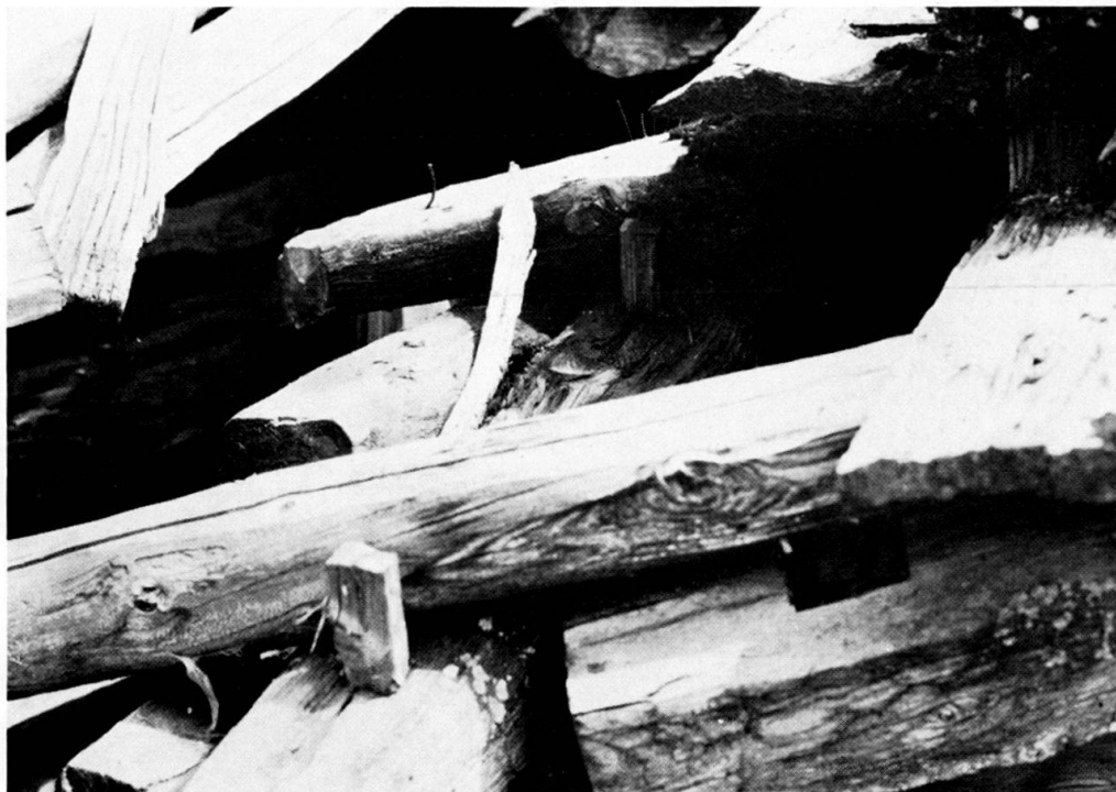
Abb. 2. Eingestürztes Dach, bei dem man die Zapfen zur Fixierung der Latten sieht.
