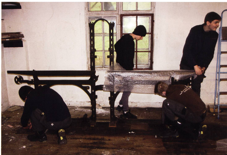
Letztes Teil, ein Schild, wird vom alten Hallenboden gelöst und die Führungsbahnen zum Schutz abgedeckt.
