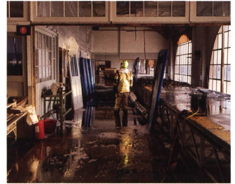
Ein trauriger Tag: Im WerkZwei brannte das Dach der Webmaschinenhalle. Die Firma TdS erwischte es ganz gewaltig: Blick in die Druckerei am Tag nach dem Brand. Foto: Martin Schlegel, TdS
