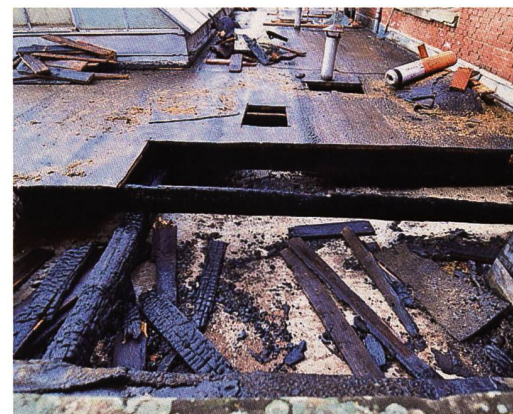
Verkohltes Gebälk im Zwischenboden des Werkhallendachs
