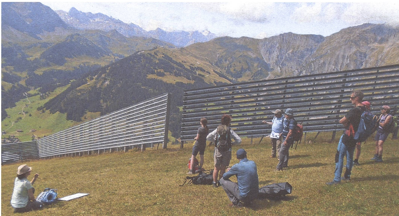
Lawinenschutzwand, die der Verfrachtung von Schnee dient: Durch die Öffnungen strömt Wind, sodass der Schnee an Stellen geblasen wird, wo er nicht zur Lawine werden kann.
