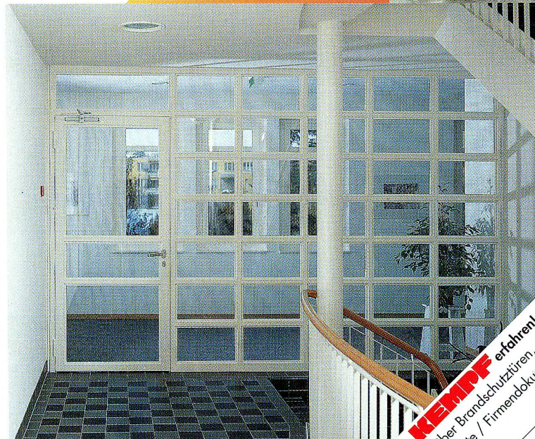
Brandschutzabschlüsse im Altersheim Dietikon ▲
