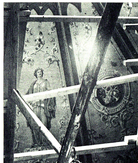
7 Ausschnitt aus der Deckenbemalung des Zuschauerraumes von Angelo Quaglio aus München, 1857. Die Malereien wurden bei der Neugestaltung 1938 entfernt (Archiv der Bauverwaltung der Stadt St.Gallen).
