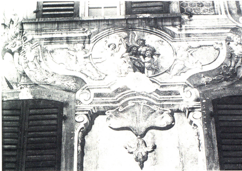
6 Zug, Brandenberghaus, Unterbau des Scheinerkers, Zustand vor der Restaurierung von 1952.
