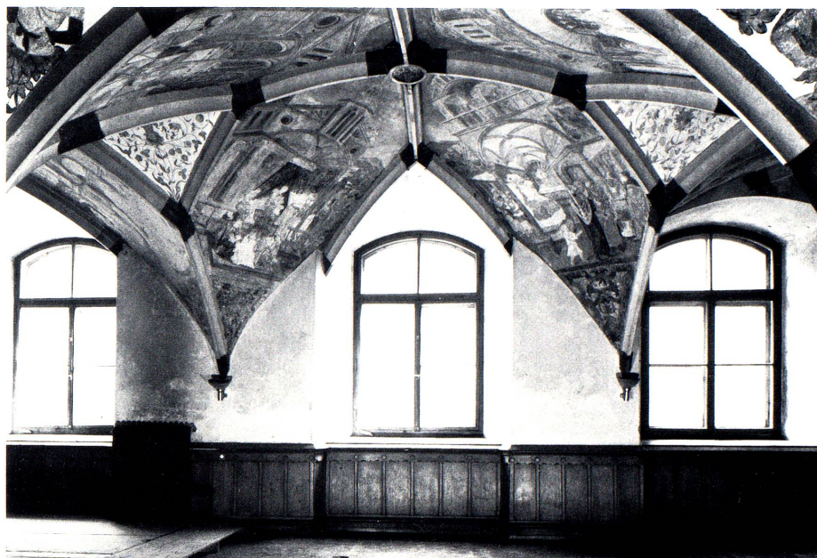
Aussenwand des Musiksaales vor Restauration.
