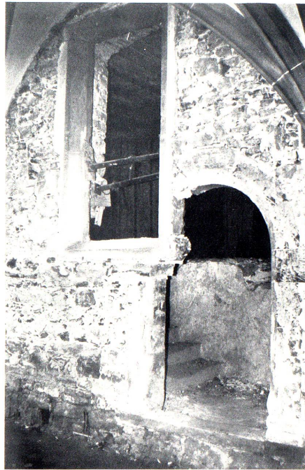
Bei der Entfernung des Mauerwerkes in der alten Türöffnung wurde dahinter der ehemalige Treppenaufgang zum Zwischengeschoss entdeckt. Hier zeigt sich deutlich die nachträgliche – sicher unerwünschte – Fenstervergrößerung vom Zwischengeschoss zum Kreuzgang.
