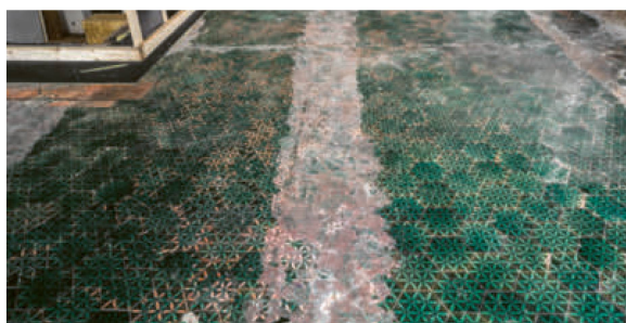
Les carreaux au sol ont été dégagés, restaurés et reconstruits pour rendre à l'aile ouest historique, là où cela était possible, son apparence de 1898.
