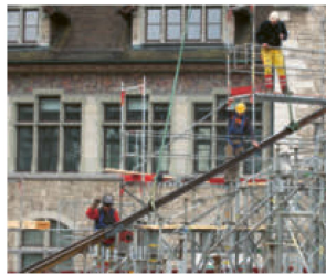
Les échafaudages laissent pour la première fois entrevoir le mariage du moderne et de l'ancien.
