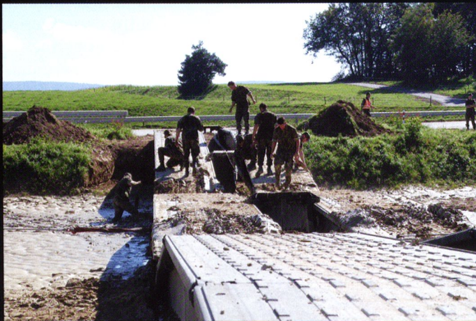
Plusieurs ponts peuvent être posés l'un sur l'autre, pour augmenter la portée du franchissement.
