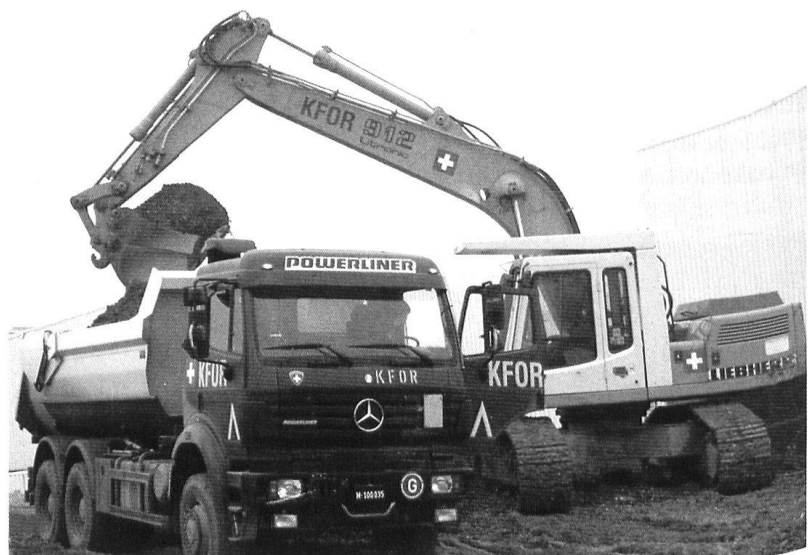
Avec la venue de la section d'infanterie mécanisée, l'augmentation des effectifs a nécessité quelques travaux supplémentaires dans l'enceinte du camp.
