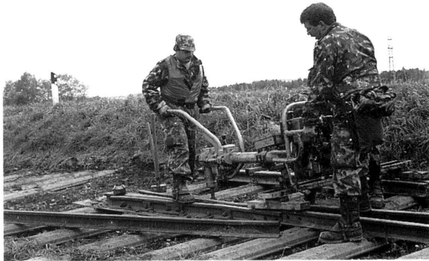
Sapeurs chemin de fer du bataillon du génie des chemins de fer 12 (travaux de contrôle en gare, Palézieux 1994).
