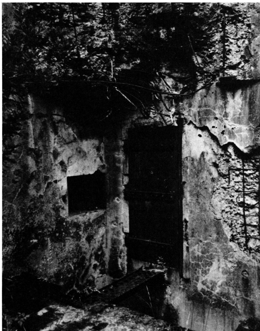
Petit ouvrage de Bambesch, bloc sud (entrée) pris à partie par obus de rupture émis par un canon de Flak à 300 ou 500 m.
