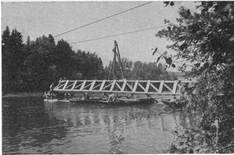
FIG. 3. — Mise en place d'une poutre à treillis à l'aide d'un bac. (Photo W. Kollros. Cliché Techn. Mitt.)
