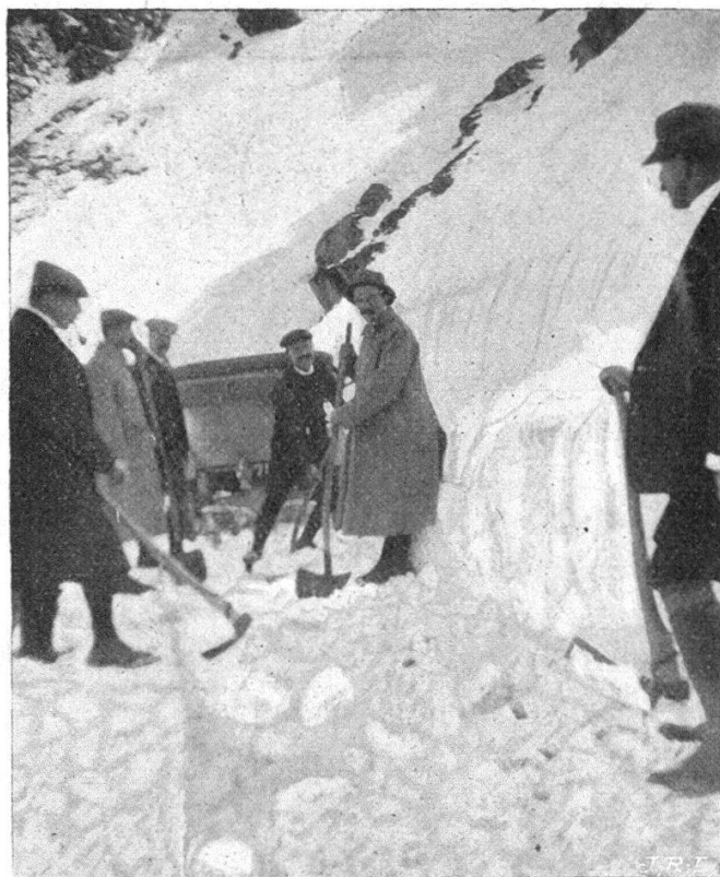
Deblaiement de la route encombrée par les avalanches.
