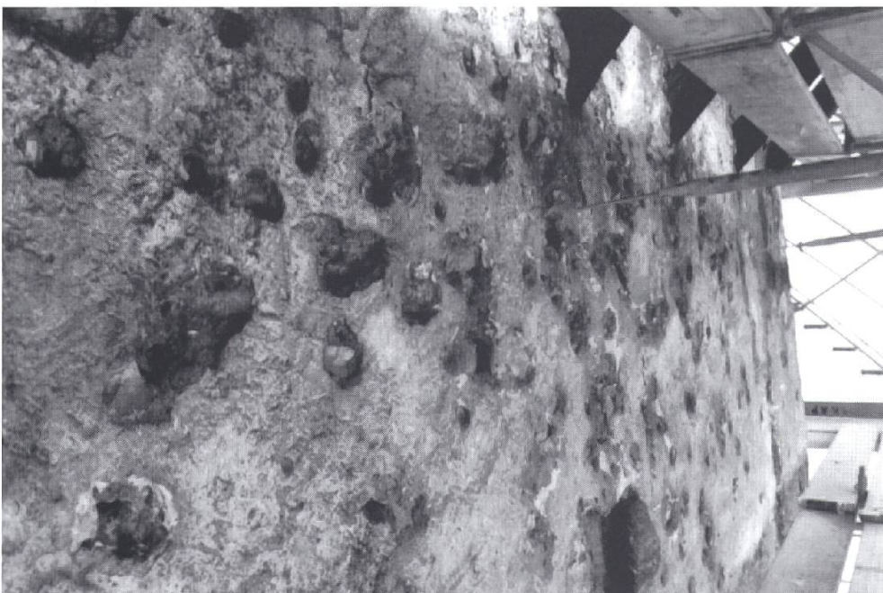
Einschusslöcher im oberen Bereich der Ostfassade (Foto G. Meier).
