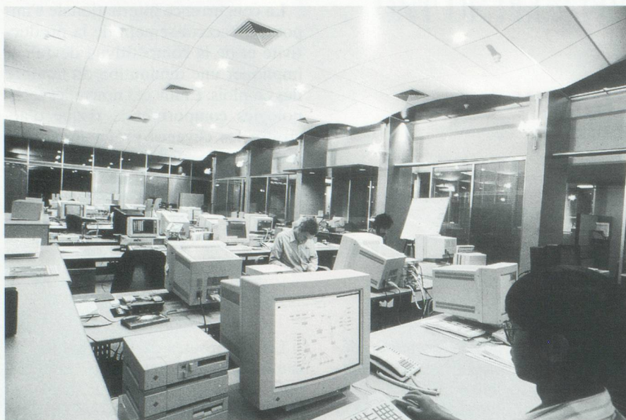
Le Centre national de supervision de RENATER, Paris Photo : M. Reynaud, © France-Télécom.
