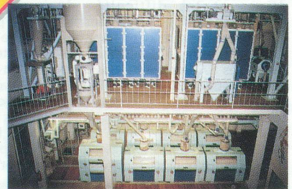
Moulin de Surgères, 200 t/24h
