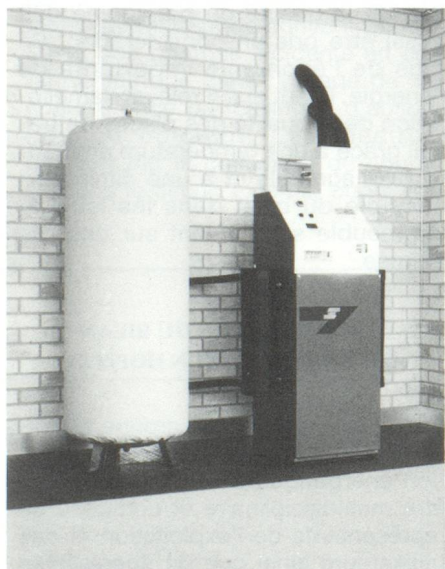
Chaufferie avec pompe à chaleur et stock-tampon d'eau chaude. © Entreprises Electriques Fribourgeoises.
