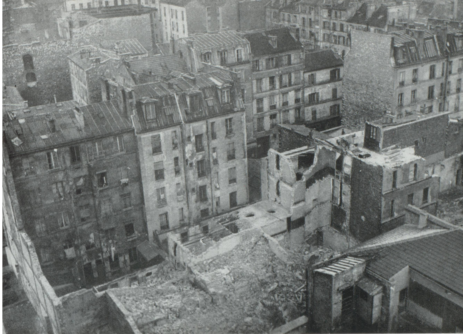
Trop de Parisiens habitent encore des taudis qu'il faut livrer à la pioche des démolisseurs. Ci-dessus, une vue de l'îlot insalubre n° 11 à Paris (photo du service technique de la Préfecture de police).
