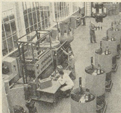
Six redresseurs mono-anodiques sans pompe à vide, formant un groupe de 3.600 A à 850 V dans l'un des halls de montage des Ateliers de Sécheron.
