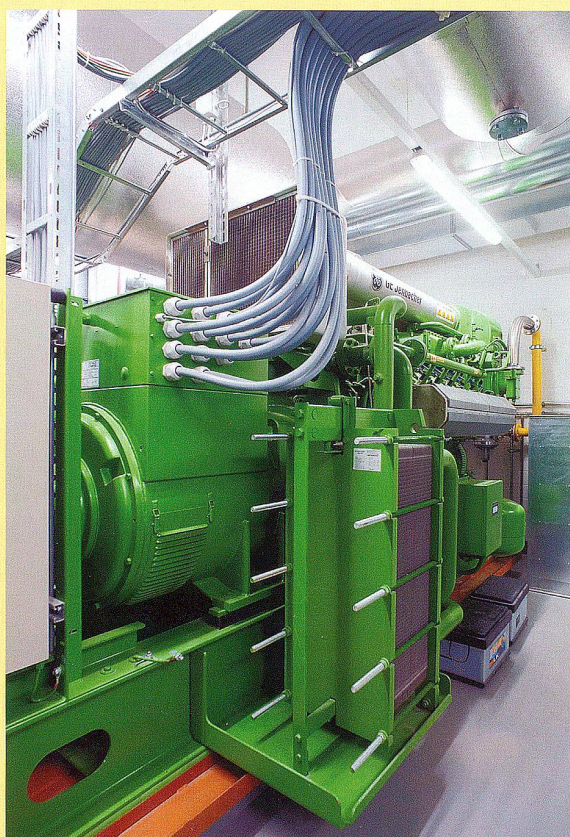
Die zwei Blockheizkraftwerk-Aggregate produzieren jährlich rund 4 Mio. kWh Strom, was einem Strombedarf von ungefähr 800 Einfamilienhäusern entspricht.
