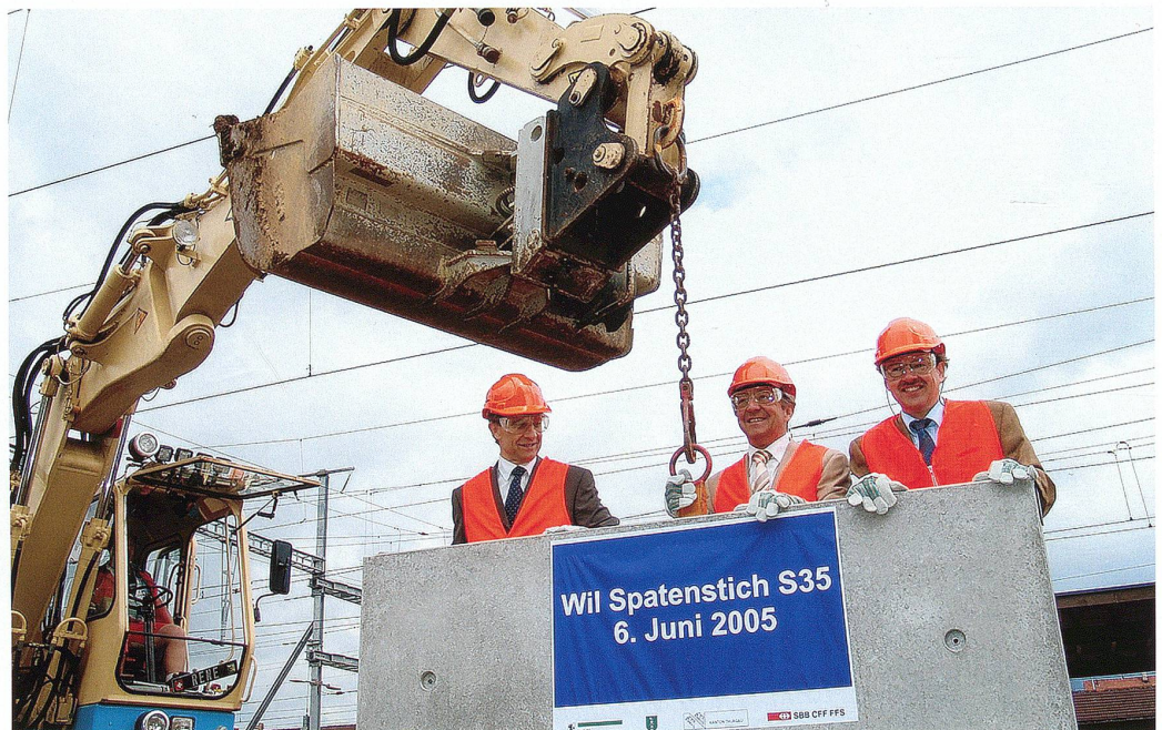
Wegen der S35 muss in Wil für das Gleis 6 ein neuer Perron erstellt werden. Werner Müller, Leiter Öffentlicher Ver-kehr Thurgau, Stadtpräsident Bruno Gähwiler und Peter Jedelhauser, Leiter Infrastruktur und Management SBB (v.l.n.r.), vollziehen den symbolischen Spatenstich, indem sie das erste Element setzen.
