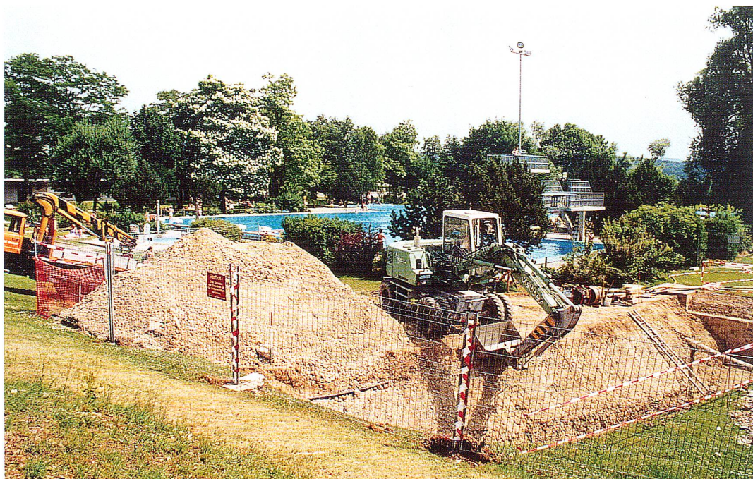
Die Sanierung der defekten Wasserleitung riss ein Loch von 100 000 Franken in die Kasse.
