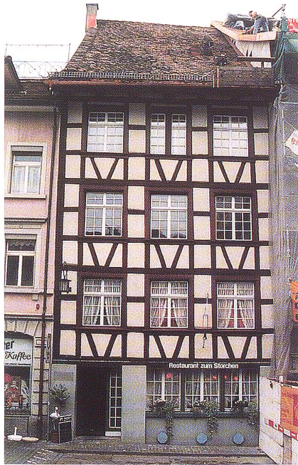
Das Restaurant zum Storchen in der Wiler Altstadt wurde kürzlich einer Aussenrenovation unterzogen.
