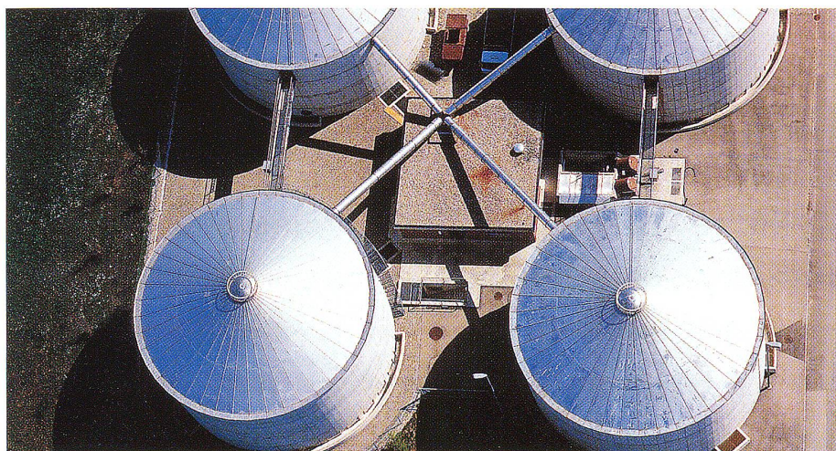
Chromstahl-Überdachung von Faultürmen
