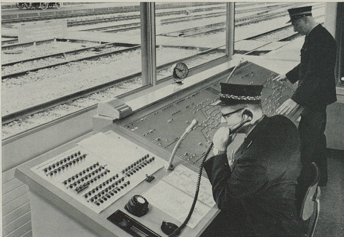
Pupitre «domino», de conception moderne, dans le poste d'enclenchement de la gare de Ziegelbrücke...
