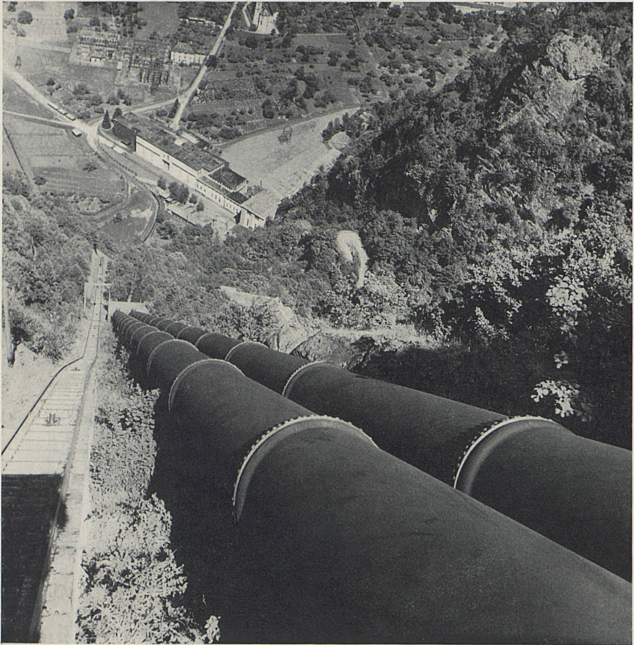
Conduites forcées de l'usine de Vernayaz
