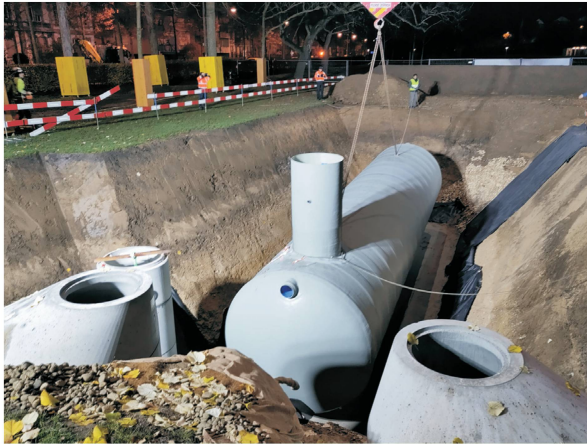
Abb. 3 Um die wertvolle Ressource des Trinkwassers zu schonen und trotzdem wichtige Grünanlagen als Entlastungsräume für Stadtbewohnende bewässern zu können, werden in Basler Grünanlagen zunehmend Wassertanks verwendet. Für den Margarethenpark wurde der Tank mit 15m Länge und einem Volumen von 100m 3 nachts angeliefert und in die vorbereitete Grube versetzt. Das darin gefasste Wasser aus Quellen und Planschbecken wird für gezielte Bewässerung in den Sommermonaten verwendet und trägt so zu einer grossen Einsparung von Trinkwasser bei. © & Foto: Stadtgärtnerei
