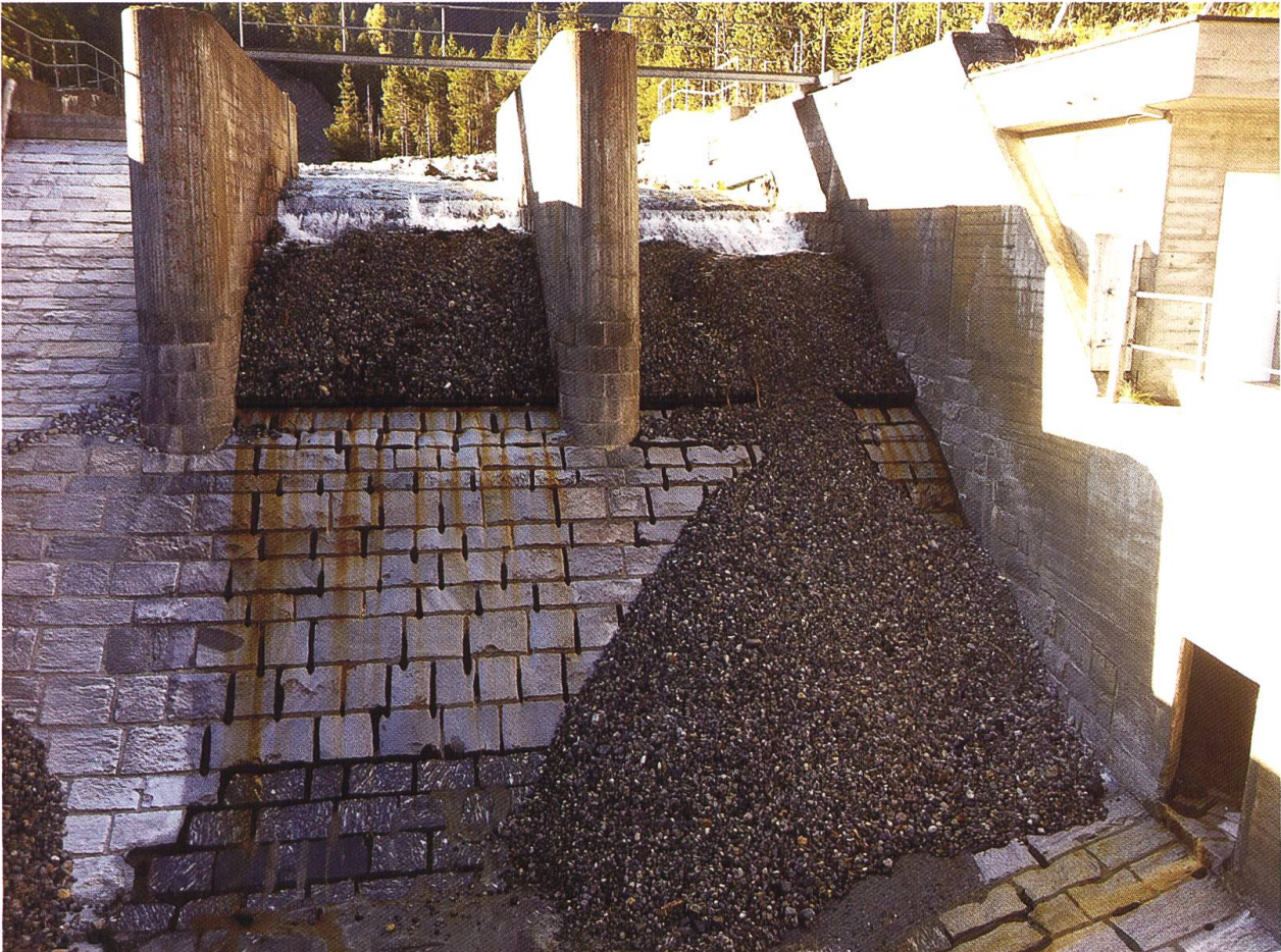
Abb. 2 Die Wasserfassung in der Clemgia, Scuol: Das gesamte Bachwasser fliesst über Rechen (Tiroler Wehr) in das Wasserkraftwerk. Der Bachverlauf ist komplett unterbrochen. Um den Gewässerlebensraum zu vernetzen und die Fischwanderung wieder zu ermöglichen, muss diese Anlage saniert werden. Aktuell koordiniert der Kanton ein Variantenstudium für eine wirksame und finanzierbare Sanierung.
