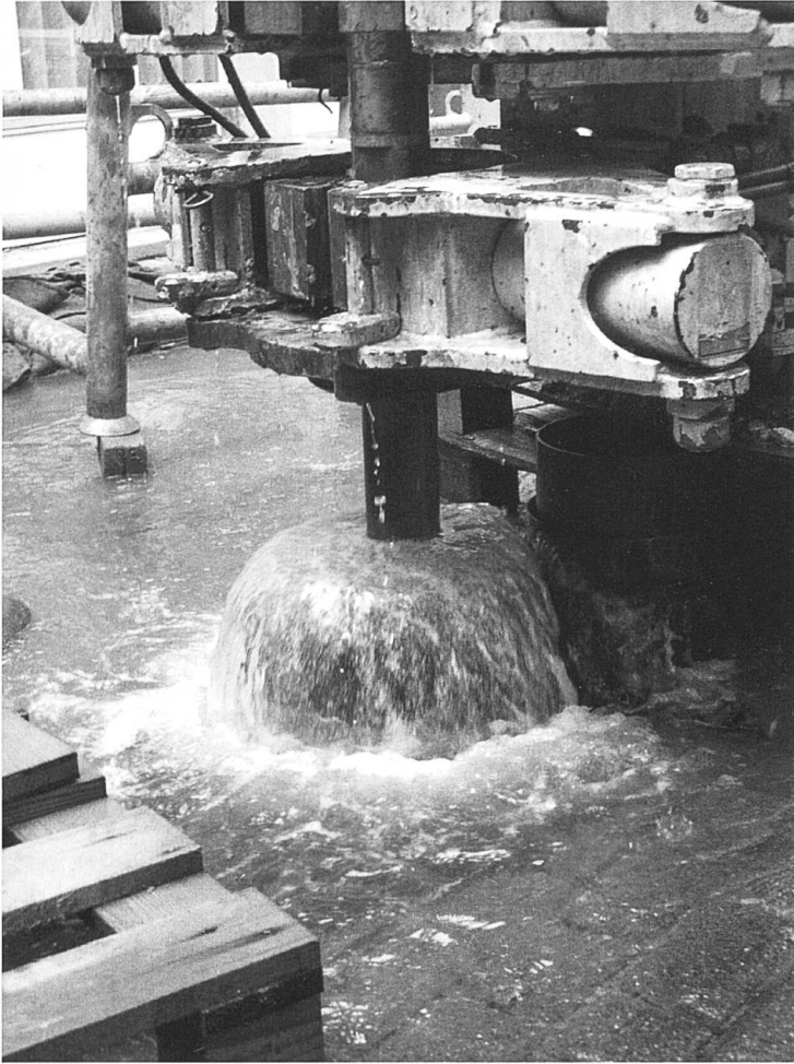
Abb. 1 Um das unzureichend verschlossene Bohrloch korrekt zu verschliessen, musste es 2010 erneut aufgebohrt werden. Bei einer Tiefe von 186 m wurde ein Holzpacker gesetzt, darüber wurde das Loch auszementiert. Das Foto zeigt den Arteser während der Bohrarbeiten im Jahr 2010.
