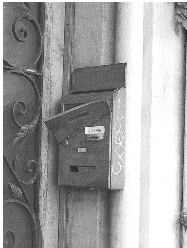
d) Beschädigter, aufgebrochener Briefkasten
