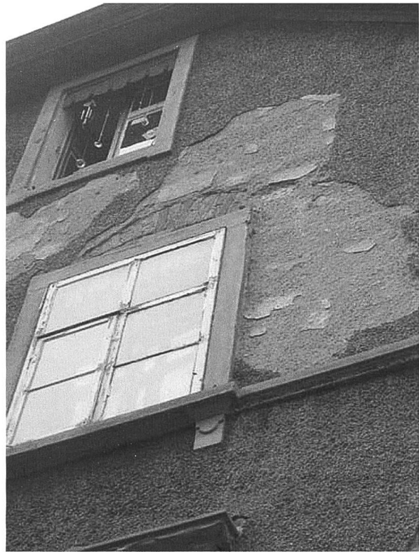
b) Schlecht unterhaltene Fassade mit sehr starken Verputzschäden
