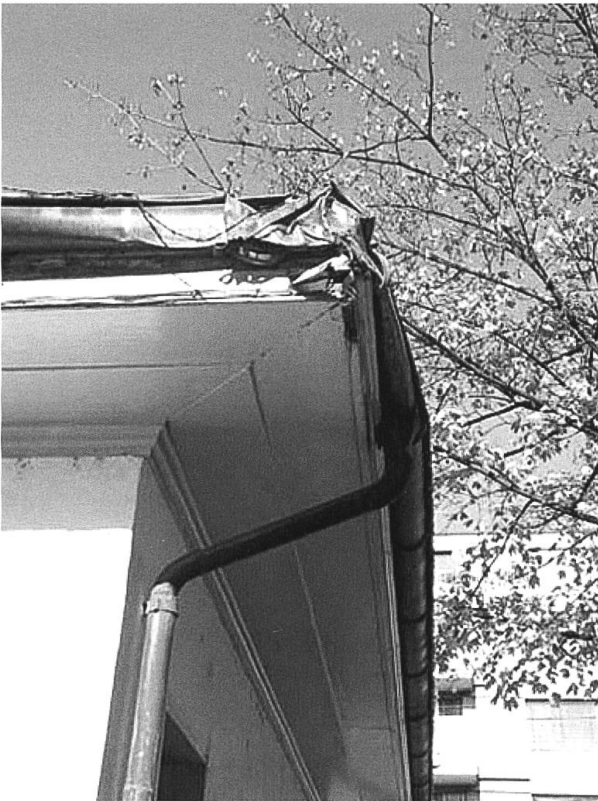
e) Beschädigte, funktionsuntüchtige Dachrinne
