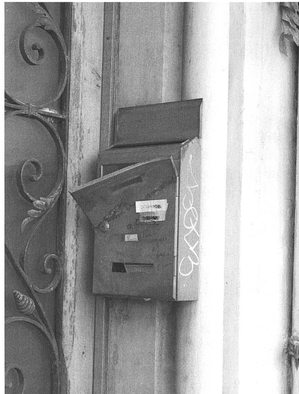
d) Beschädigter, aufgebrochener Briefkasten
