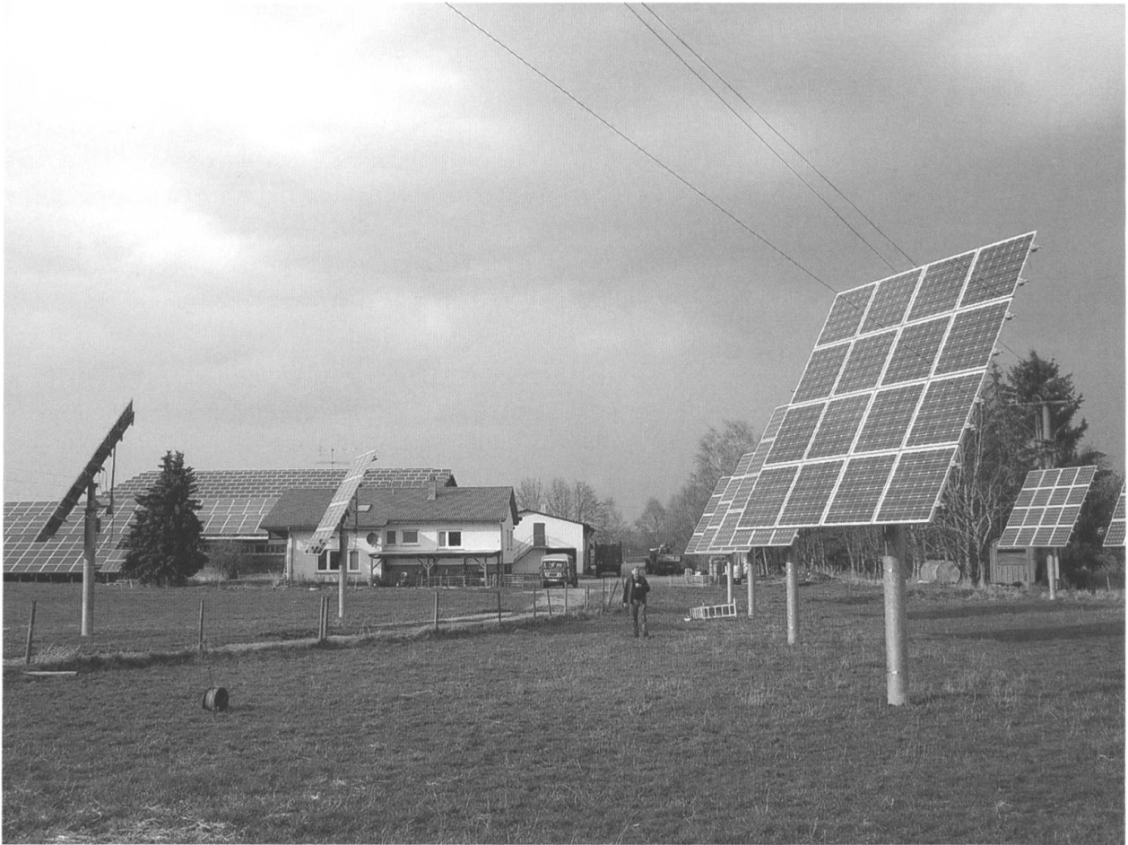
Abb. 2 Gebäudeintegrierte sowie dem Sonnenstand nachgeführte Solaranlagen des Schäferhofes bei Donaueschingen; Leistung insgesamt: 121 kWp (kW peak ; Peakleistung = Spitzenleistung).
